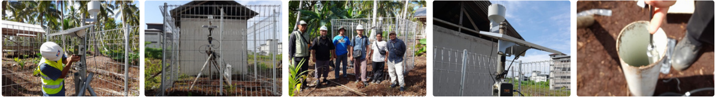
Instalasi AWLR & perangkat Weather Station, di Dermaga Pelabuhan, Tahun 2023, Client: Kemertian Lingkungan Hidup & Kehutanan
