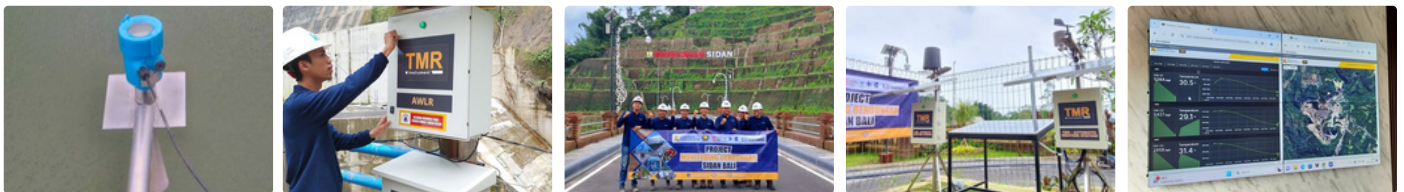
Instalasi AWLR & perangkat sistem telemetri lainnya, di Bendungan Sidan Bali, Tahun 2024, Client: PT Brantas Abipraya
