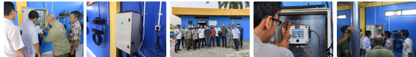
Instalasi AWLR untuk Tinggi Muka Air Tanah : Tanjung & Marunda Jakarta Utara, Tahun 2021, Client: Dinas SDA DKI Jakarta
