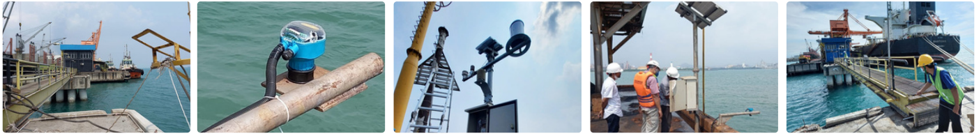
Instalasi AWLR & perangkat Weather Station, di Dermaga Pelabuhan, Tahun 2023, Client: PT Krakatau Bandar Samudra
